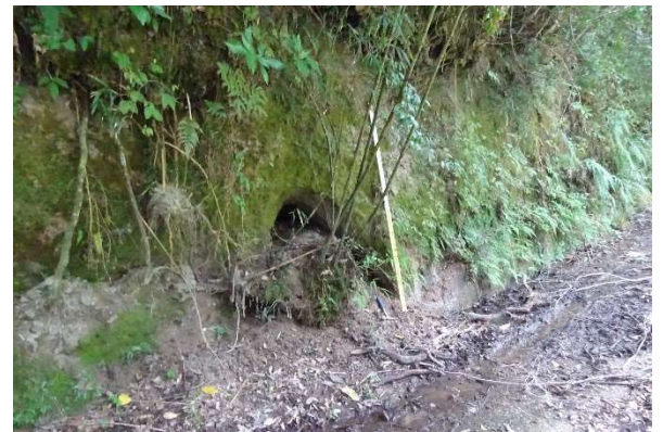
図-2 大崩南沢洞窟（林道法面に残存する洞窟土塊）
